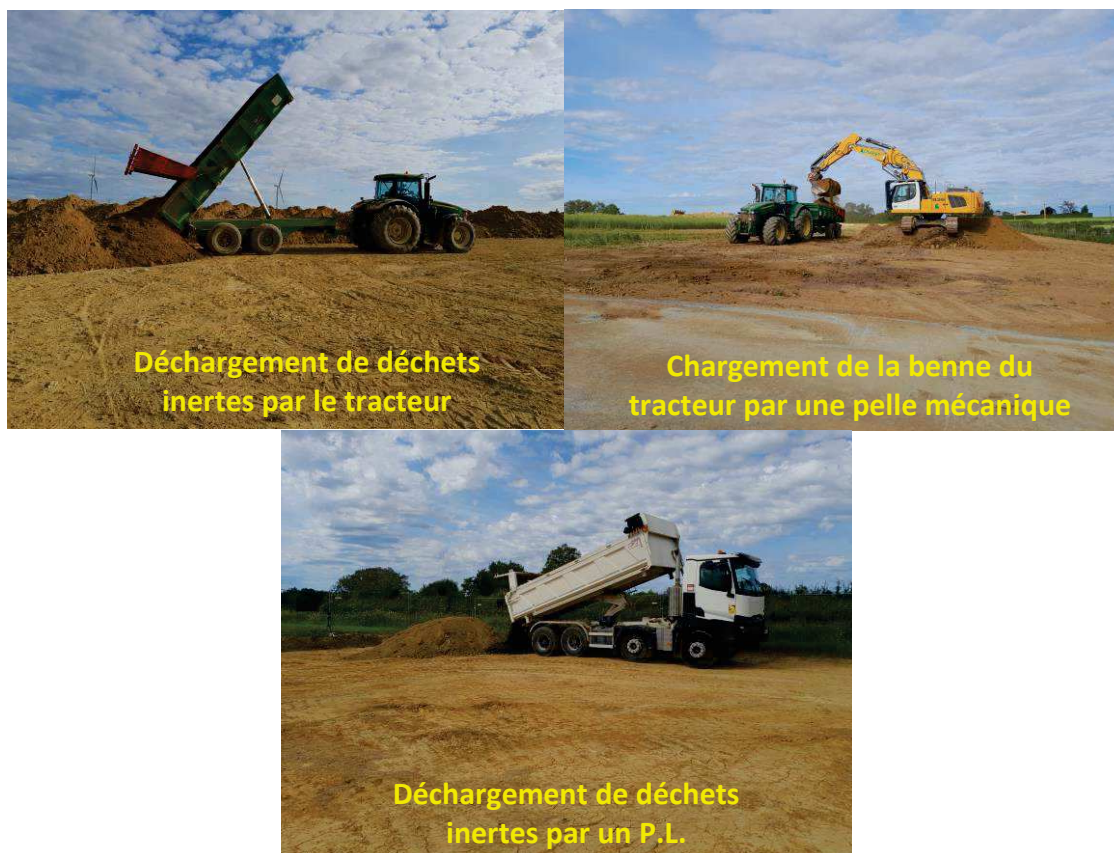
Figure 1 : Prises de vue des sources de bruits associées à l'exploitation
